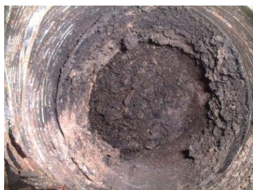
排気ダクト内の油脂
