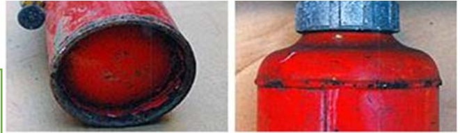
黒く変色している消火器
