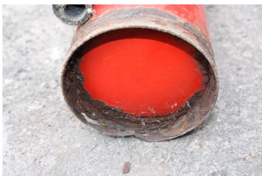
底溶接部と周辺の腐食
