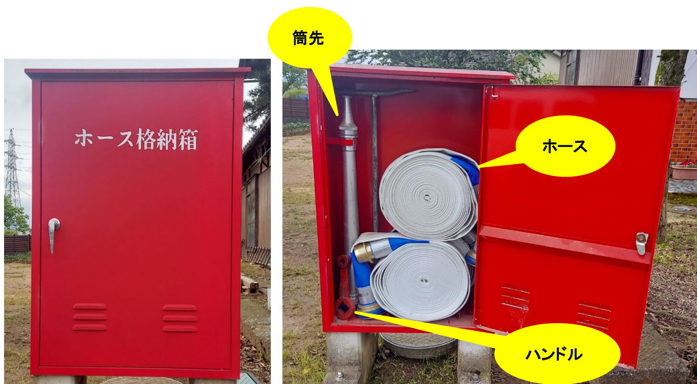
(写真) 消火栓ホース格納箱の中
